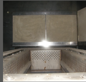
HABILAGE LATÉRAL DU FOYER EN BÉTON RÉFRACTAIRE ET HABILAGE SUPÉRIEUR EN INOX.
